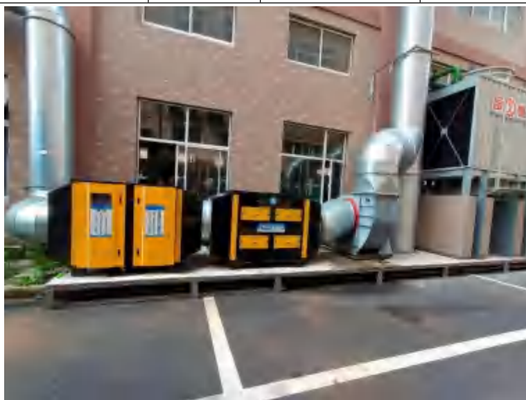
图 4-1 废气处理设施
